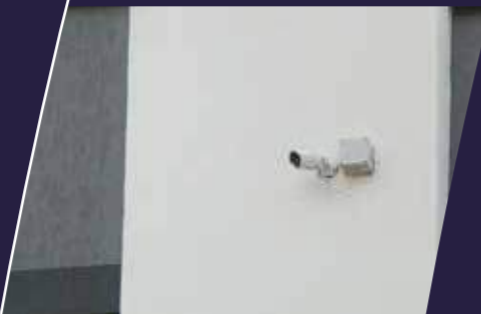
Видеонаблюдение на всей территории района, в том числе в подъездах
