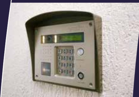
Панели вызова домофона внутри здания в теплом тамбуре
